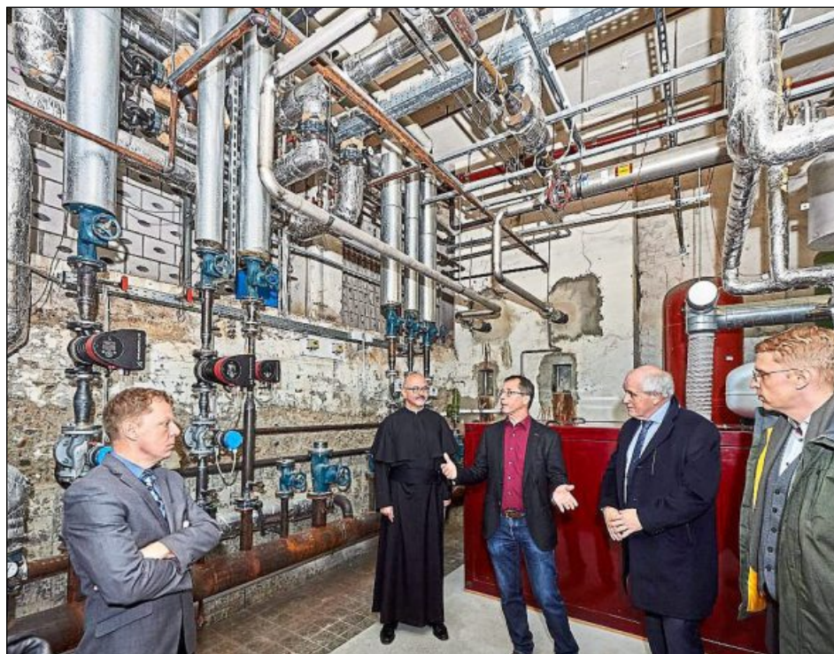
WÄRMESPENDER IM KELLER: Ingenieur Andreas Gerlach (Mitte) erklärt die Funktion der Heizanlage im Gymnasium St. Paulusheim.
